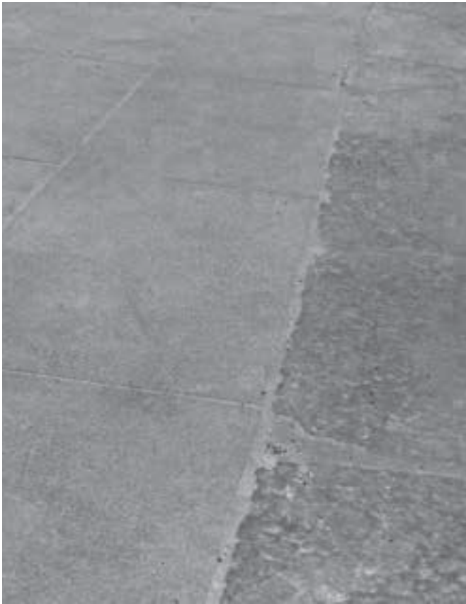
Encuentro porcelánico técnico con piedra original Join between technical porcelain and original stone
